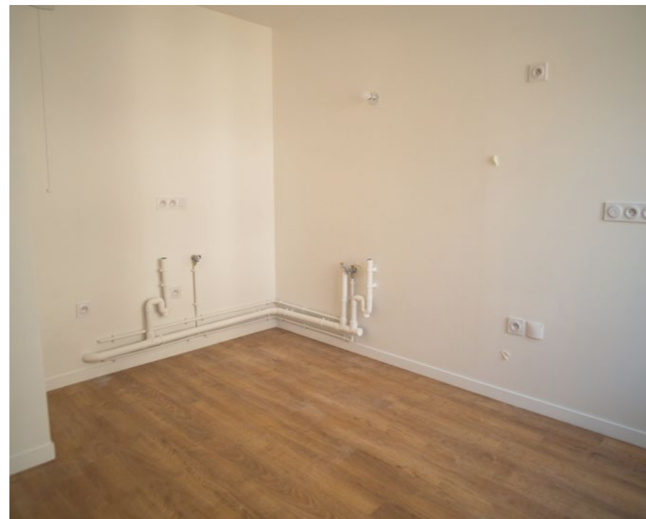
Un réseau de raccordement d'une cuisine en cours de travaux dans une ancienne chambre d'athlète
