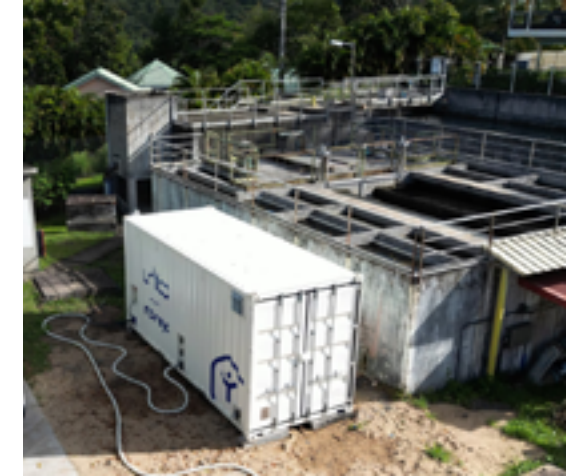
Installation d'UnYo® en Guadeloupe
